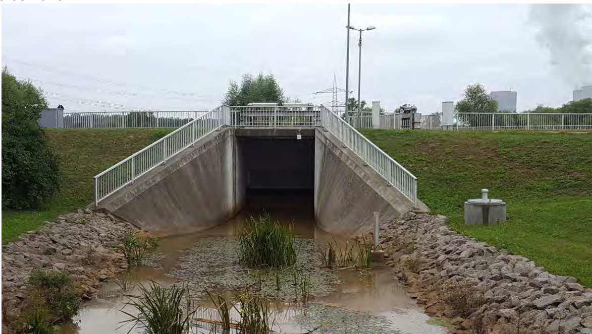
Abb. 8: Dükerbauwerk für den Ableiter Hainer See unter dem Zuleiter zum Stausee Rötha Nähe Trachenauer Wehr 09.08.2016
