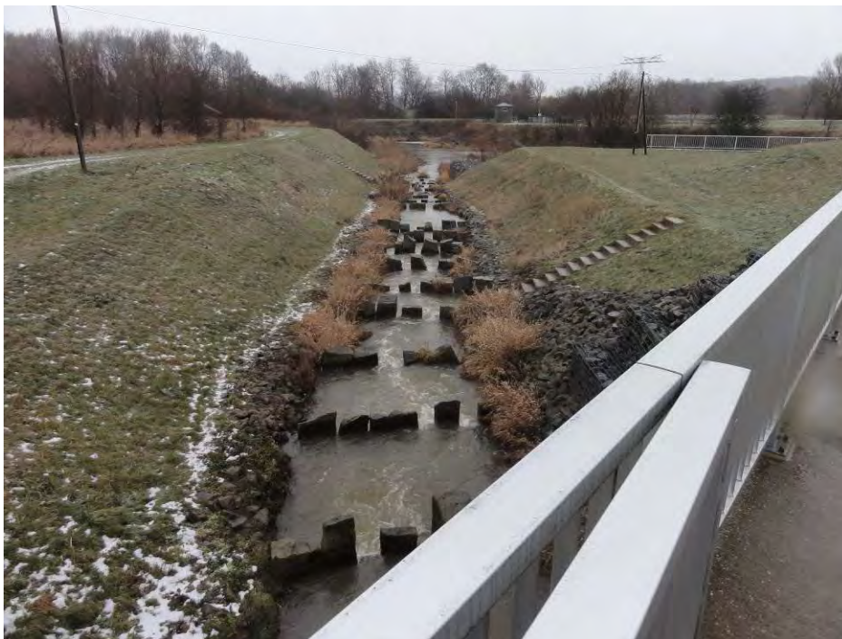
Abb. 14: Fischaufstiegsanlage am Trachenauer Wehr 13.01.2017
